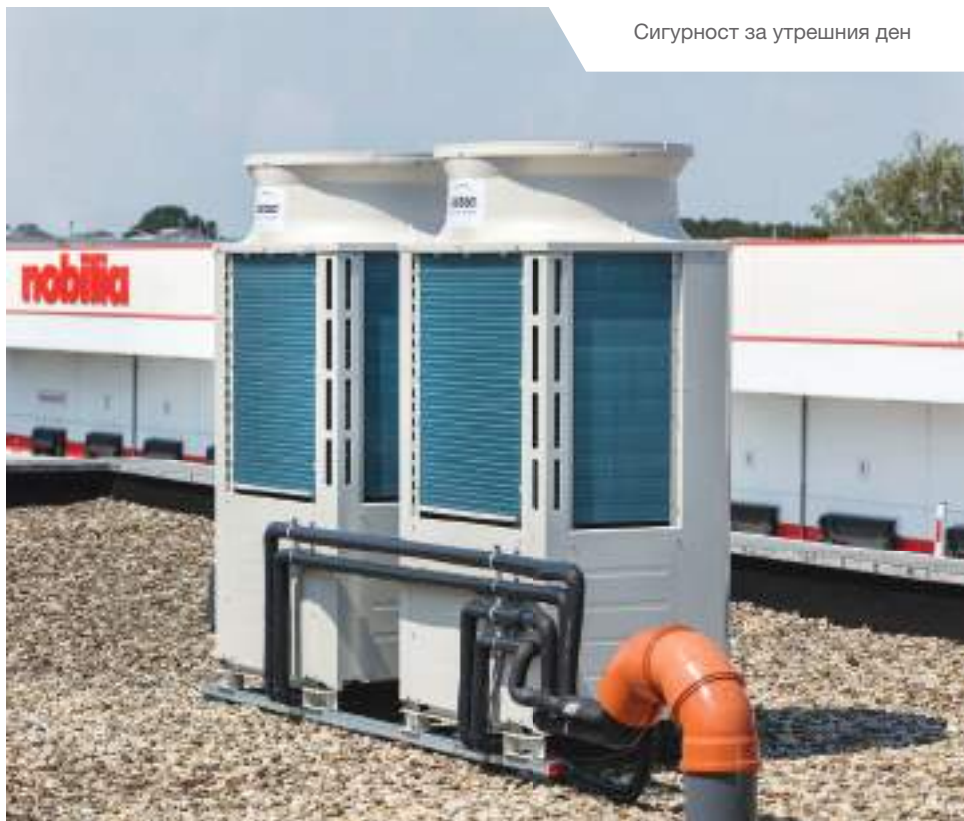
Плоският покрив на офис сградата е оптимално пригоден за монтаж на външните тела. Оттук телата City Multi VRF снабдяват двата етажа с достатъчно охладителна и отоплителна мощност.
