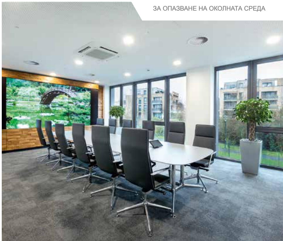
Термопомпите въздух-въздух и въздух-вода на Mitsubishi Electric снабдяват седалището на фирмата с 2 MW топлинна мощност и 2 MW студова мощност. До три четвърти от необходимата енергия се добива от околния въздух.
